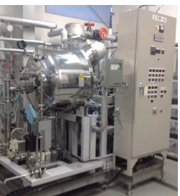
第1工場にて発酵完了液の濃縮用 エバポレーター
