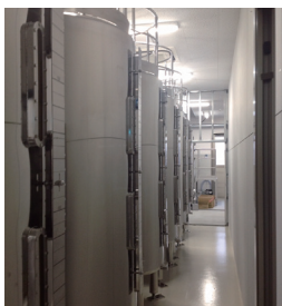
12トン 原液貯蔵タンク群
